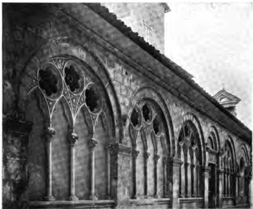
Fig. 86. — Meneaux divisant les fenêtres à l'église Santa-Maria della Rosa à Lucques (Toscane).
